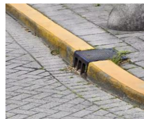
Etat des trottoirs
